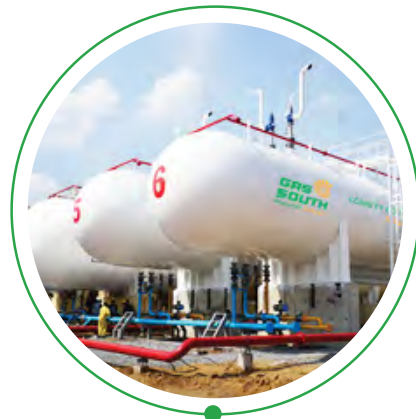
Kho và Trạm nạp LPG tại Cần Thơ (1.600 tấn), cung cấp LPG cho khu vực Tây Nam Bộ
